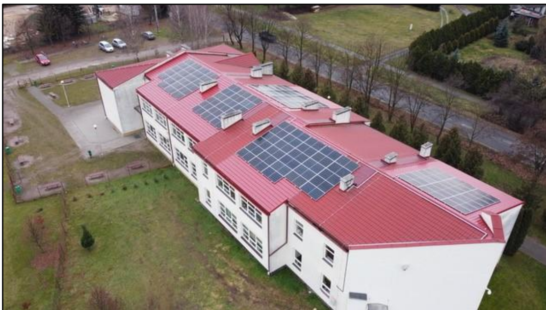
Rysunek 20 Instalacja PV na budynku szkoły.
